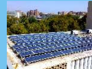
Fotovoltaico, 1Mw - Valencia ES
