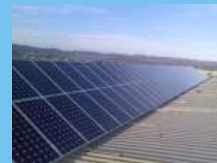
Fotovoltaico, 160kw - Valencia ES
