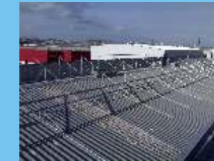
Fotovoltaico, 100kw - Valencia ES
