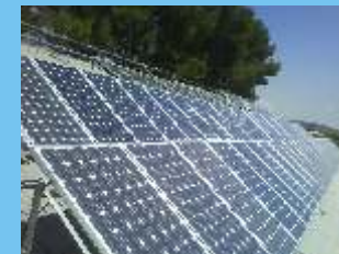
Fotovoltaico, 70kw - Valencia ES
