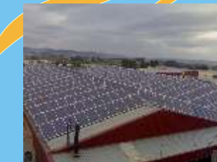
Fotovoltaico, 220kw - Valencia ES
