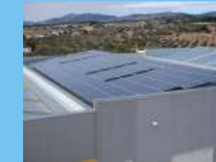
Fotovoltaico, 80kw - Alicante ES
