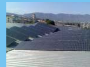
Fotovoltaico, 60kw - Alicante ES
